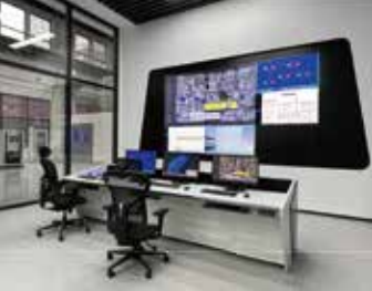
试验室综合管理平台
