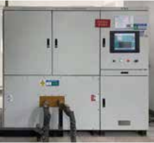
温升特性检测系统
